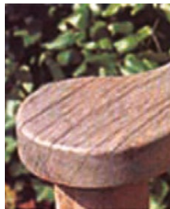
Verwittert Nach einigen Monaten bekommt das Holz eine silberfarbene Patina. Naturholzbedingte Risse treten auf.
